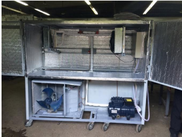
Hình 5.6 Hệ thống lạnh CO 2 được hoàn thiện
